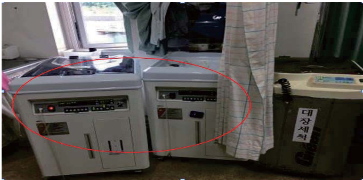
위 내시경 검사 장비를 세척하는 장비(폐수배출시설)
