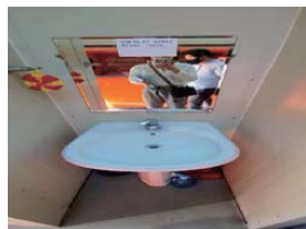
[재활용 도움센터 내 수도시설]
