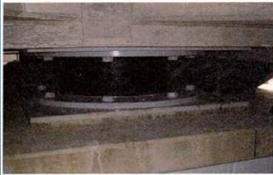
グリーンマスタンプ (けやき坂コンプレックス) Green Mass Damper (Keyakizaka Complex)
