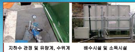
2. M시 내곡마을상수도 Q=100㎥/d (2003년 설치)
