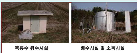
5. H군 수곡샐터 소규모급수시설 Q=80㎥/d (1996년 설치)
