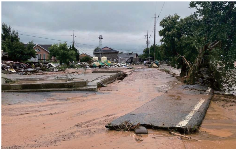
마을 건물, 안길 아스팔트 포장 피해
