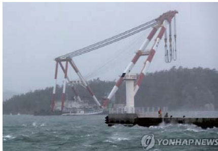
태풍(강풍)로 인한 시설물 피해
